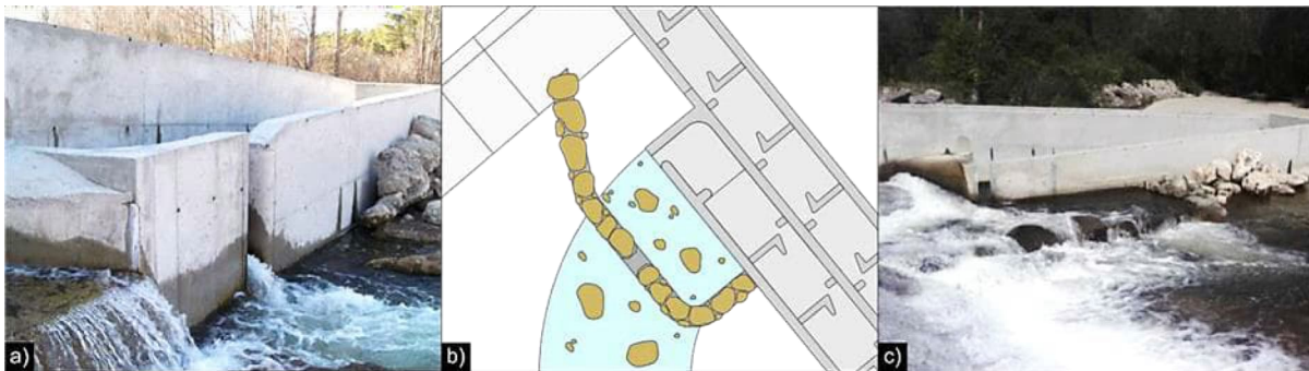
Figura 4. Corrección de deficiencias constructivas. a) Salto excesivo. b) Vertedero rediseñado. c) Solución ejecutada
