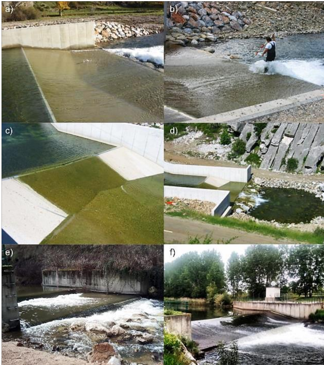
Figura 3. Diferentes ejemplos de la problemática existente. Descalce de la estructura (a, b, d, e y f). Escasa profundidad en el paramento (c y f). Alta velocidad del flujo en el paramento (b y f). Turbulencia excesiva (e)
